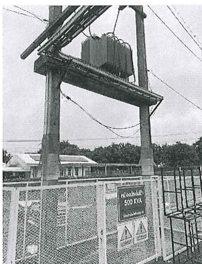
รูปภาพแสดงหม้อแปลงแรงดัน ขนาด ๕๐๐ KVA ๗๒๐ A
